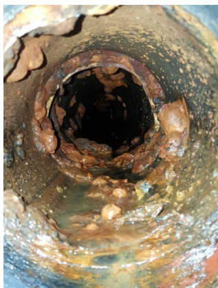
Vannrør før rengjøring
